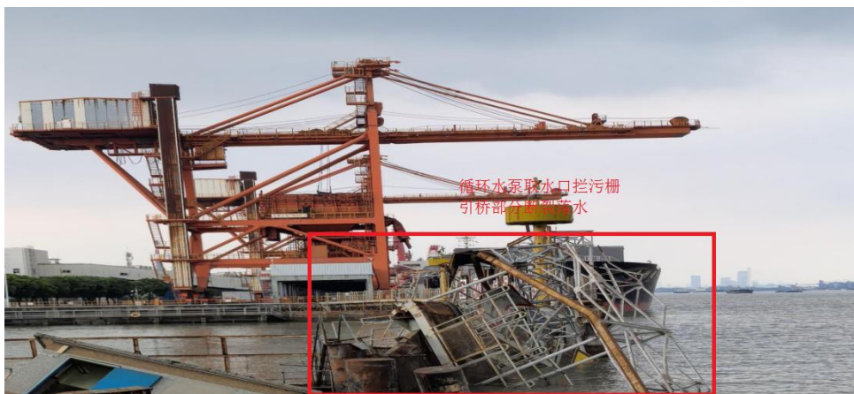
图 6：吴泾发电厂循环水泵取水口拦污栅引桥损失情况
