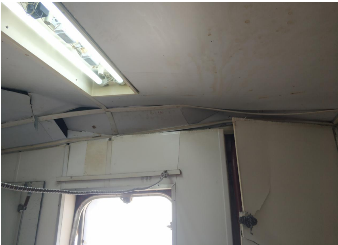
图 7：“正和 58”轮房间损坏情况
